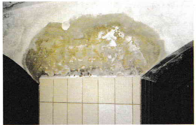
1-4 Un stâlp independent, a fost placat cu gresie în urmă cu aproximativ 20 de ani din cauza deteriorării cauzate de umiditate. Acum, umezeala se vede deasupra gresiei și este pe cale să ajungă la podeaua de deasupra.
