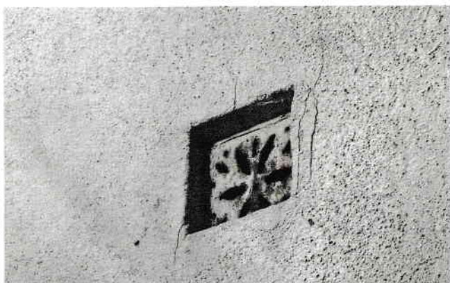
1-11 Grilaj de ventilație la o conductă de evacuare umiditate
